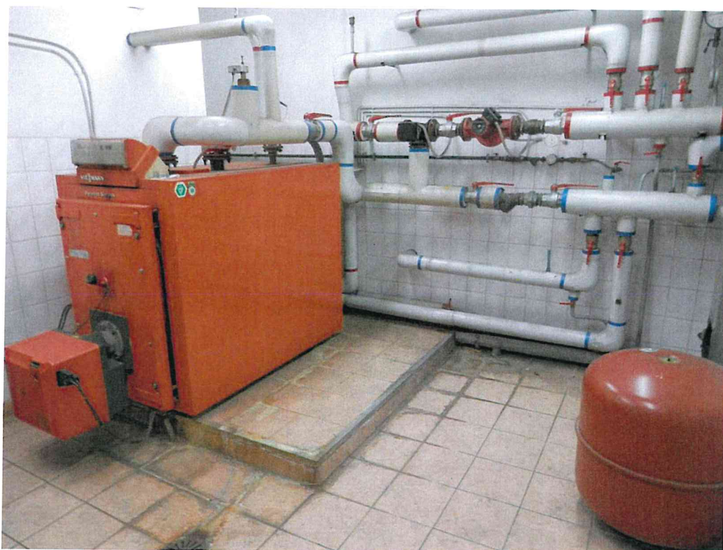
Widok kotłowni zlokalizowanej na poziomie piwnicy budynku.
