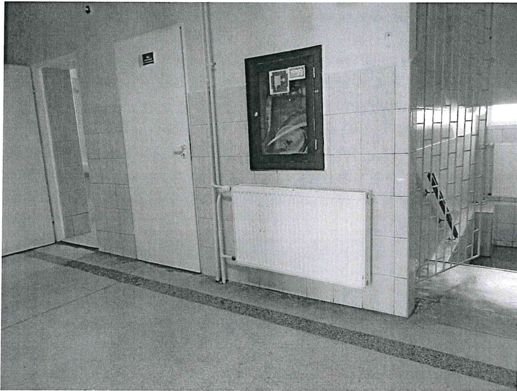
Grzejniki stalowy płytowy w układzie grzewczym budynku.
