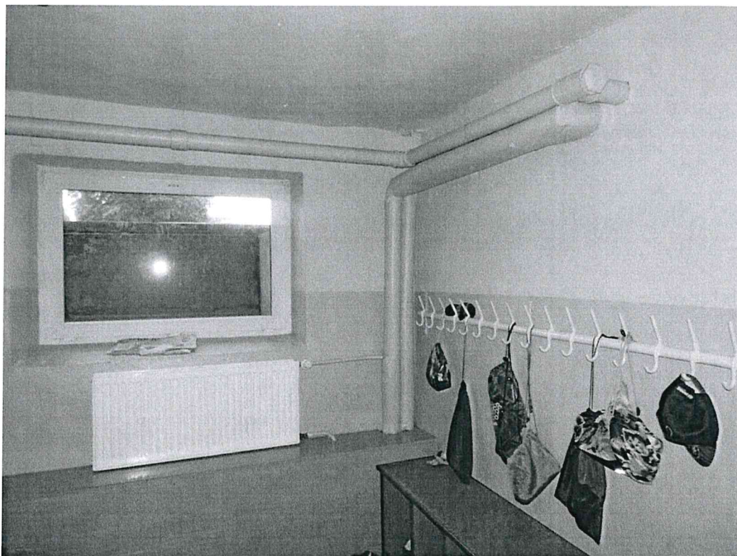
Grzejnik stalowy płytowy w układzie grzewczym budynku.
