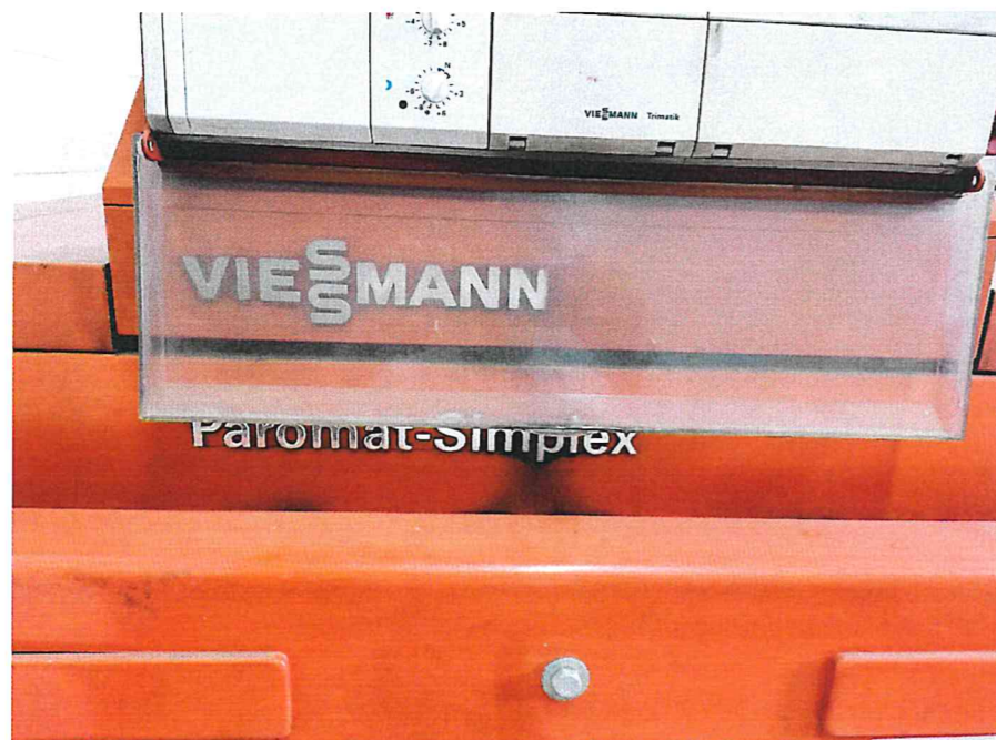
Istniejący kocioł olejowy, który będzie podlegał modernizacji.
