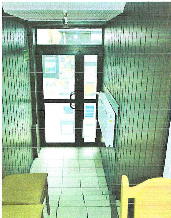
Zdjęcie 13: Nieoznaczone taśmą ostrzegawczą stopnie schodów. W głębi drzwi wyjściowe na ul. Uniejowską.
