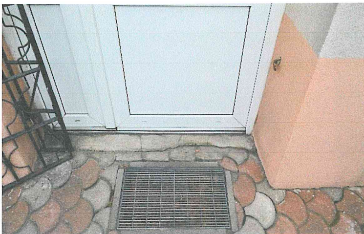
Zdjęcie 3: Wycieraczka stalowa zagłębiona w posadzce z kostki brukowej przy wejściu głównym do budynku Urzędu. Wylewka betonowa niwelująca próg. Fragment skrzydła drzwiowego, z prawej strony fragment kraty.
